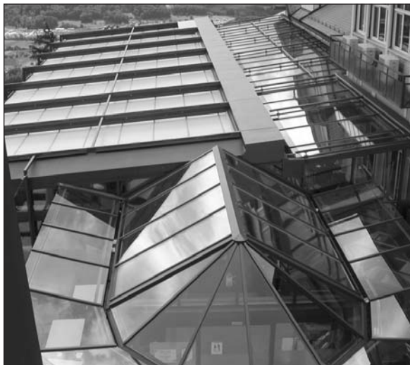
2 In Stahl und Glas total eingekapselt ist auch die Südterrasse – das ist illegal. Sie wird jetzt das ganze Jahr bewirtschaftet, im Winter aufwändig geheizt.
