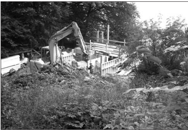
Die Brandruine des Schwesternhauses ist abgeräumt. Jetzt wird das neue Einfamilienhaus gebaut.
