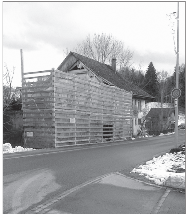
Heute ist der Anbau eine Ruine, versteckt hinter Brettern. Nur der gemauerte Teil des Stalles steht noch. Die aufgesetzte Holzkonstruktion ist zusammengestürzt.
