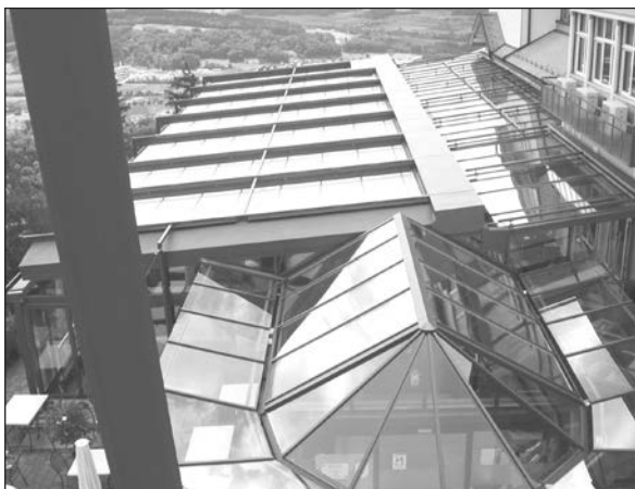
Diese Anbauten sind illegal und wurden ohne Baubewilligung erstellt. Die einst offene, frei zugängliche Aussichts-Terrasse ist jetzt Teil des Restaurants.
