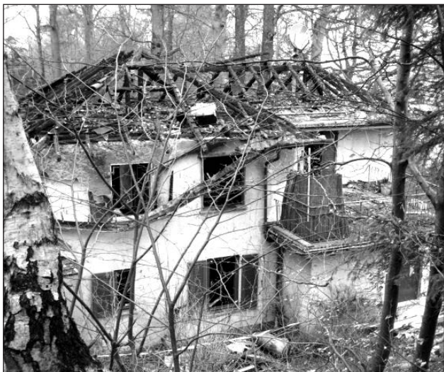
«Menschliches Fehlverhalten»: Ein Dachstockbrand hat das oberste Schwesternhaus total verwüstet.
